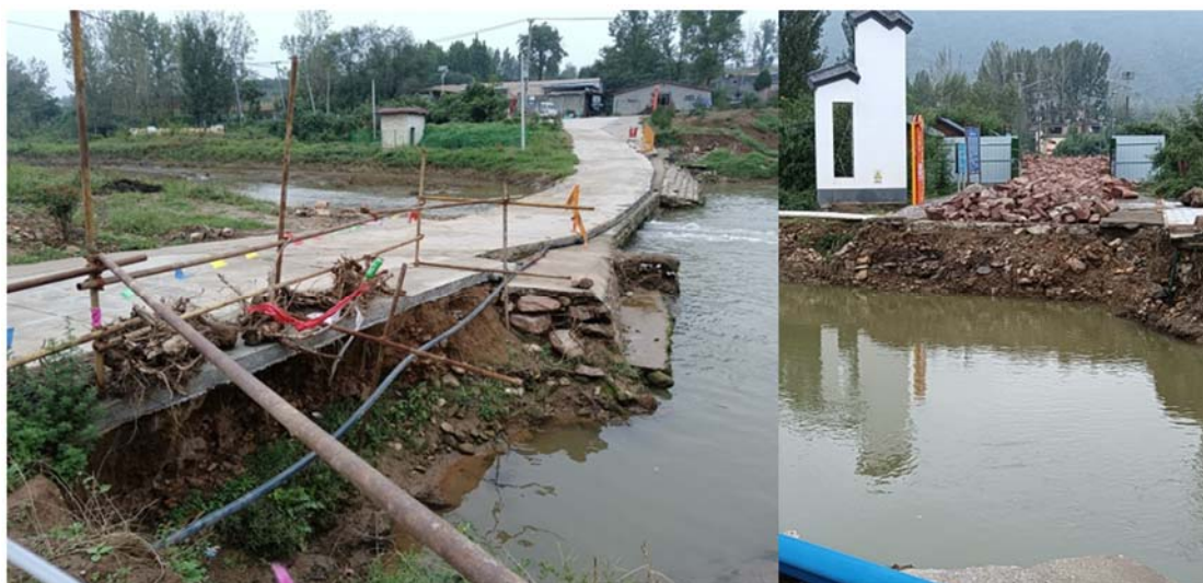
农村道路水毁情况
