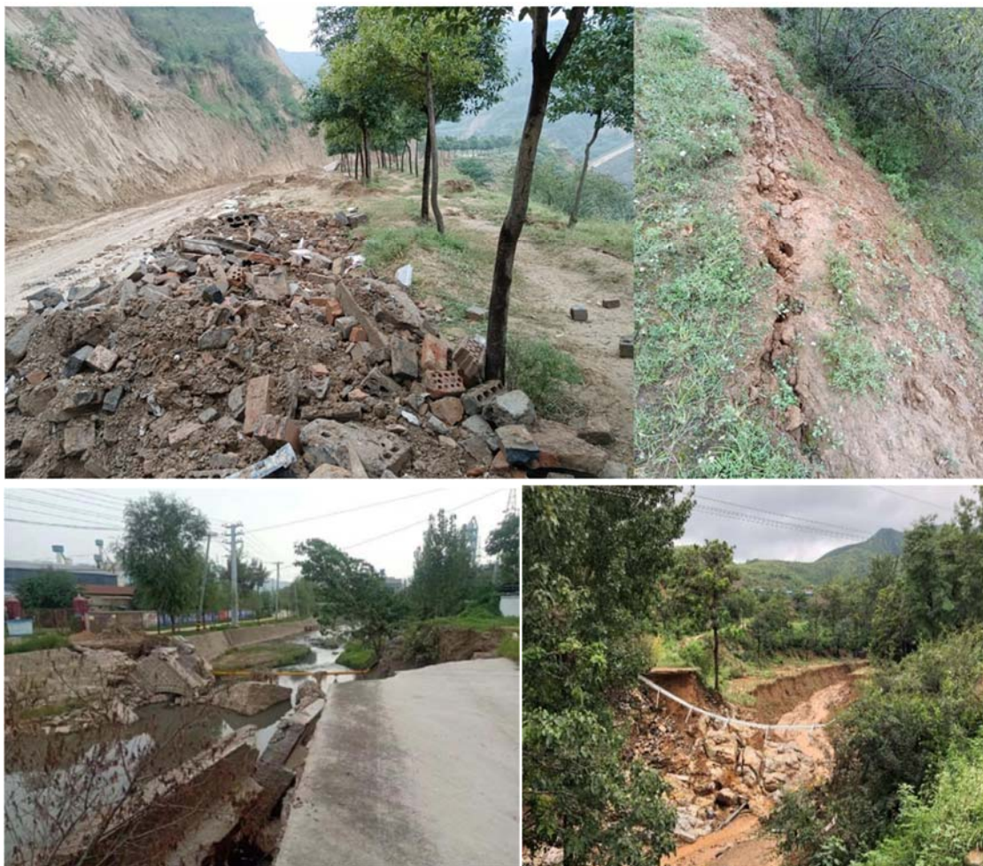
农村道路水毁情况
