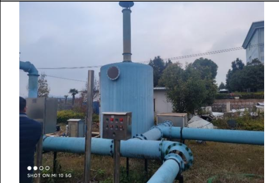
中水站除臭塔
