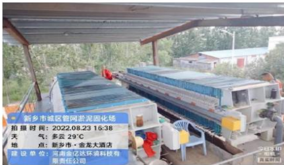
压滤机现场图
