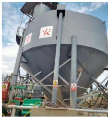
絮凝罐、柱塞泵现场图
