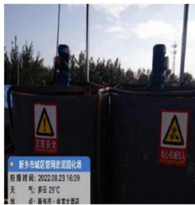
药剂罐现场图
